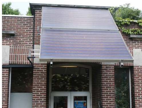
De thermische zonnecollectoren geplaatst als zonnewering
