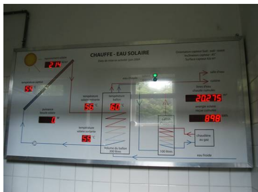
Het didactisch bord voor de thermische zonne-installatie
